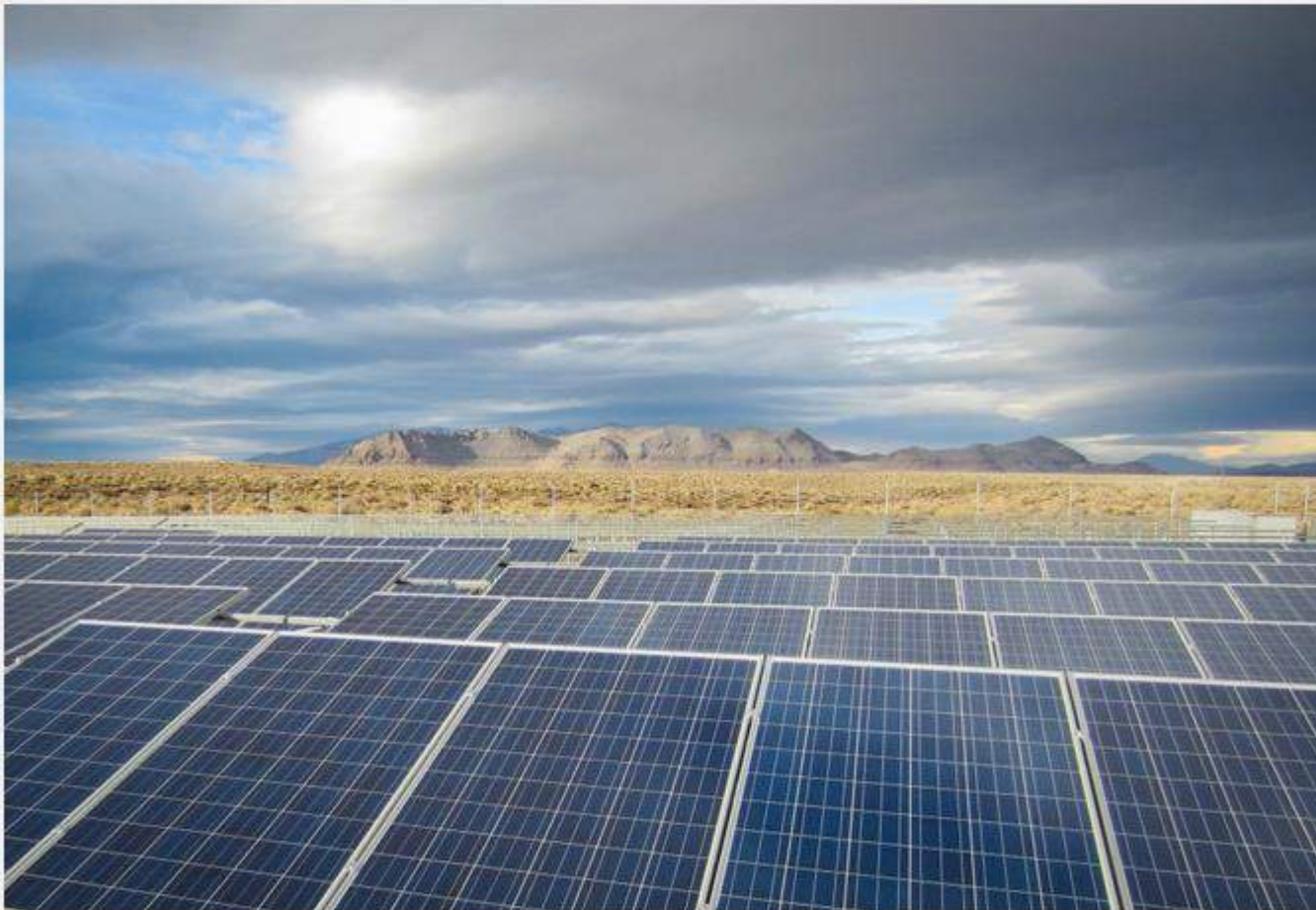
Champ de panneaux photovoltaïques dans le Nevada. © Black Rock Solar.
